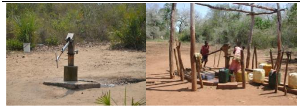
Figura 7.12 Exemplos de Bombas Manuais de Água no Distrito de Inhassoro
